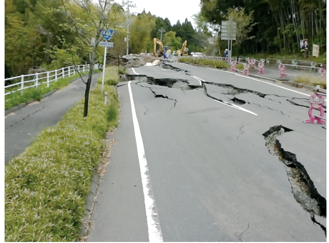
益城町の道路の被害状況 (高松市消防局提供)
